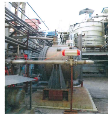
锌氧压浸出工艺生产线
