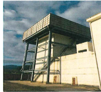
东风井喷淋除尘系统
